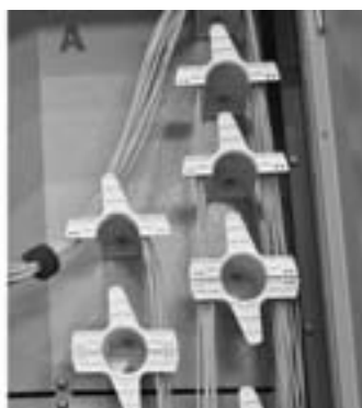
Зона выкладки запаса длины патчкордов
