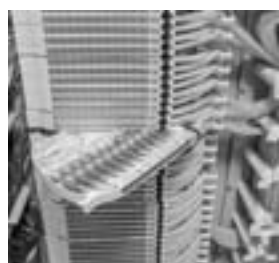
Зона монтажа и коммутации ОВ
